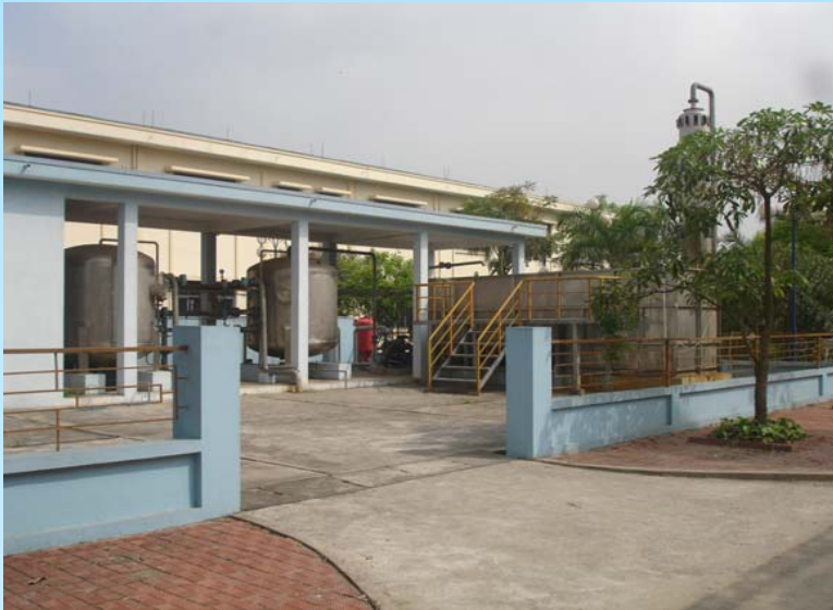
Station de l'eau sous terrain 1000m 3 /jour.
